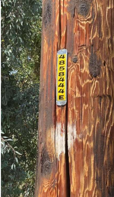
Item1GImg2: Pole ID
