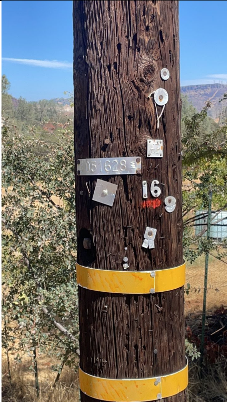
Item1GImg2: Missing Pole ID
