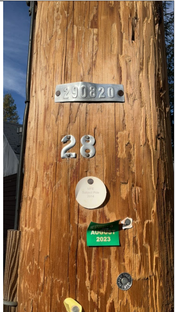
Item10GImg2: Pole ID.
