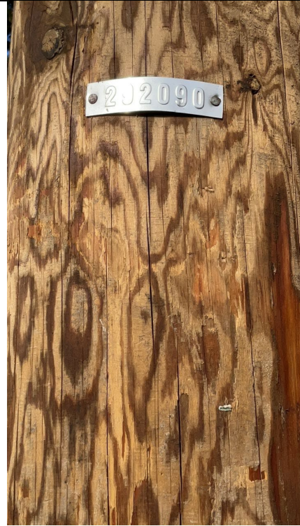
Item9GImg2: Pole ID.
