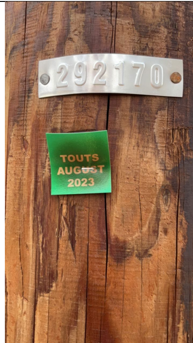
Item4GImg2: Pole ID.
