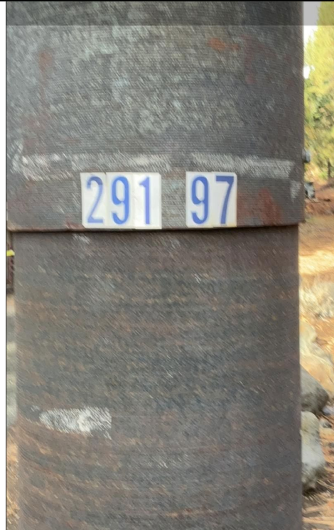
Item8GImg2: Pole ID (damaged).
