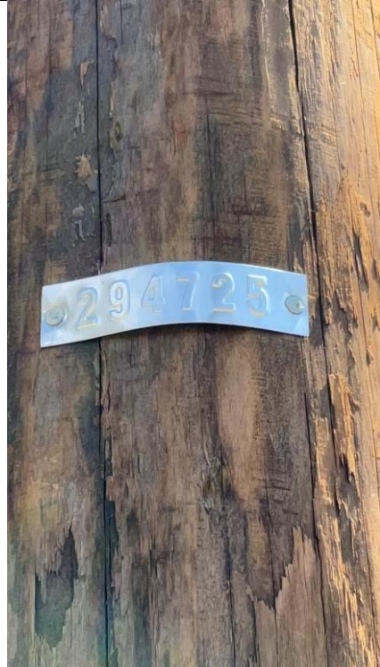
Item5GImg2: Pole ID
