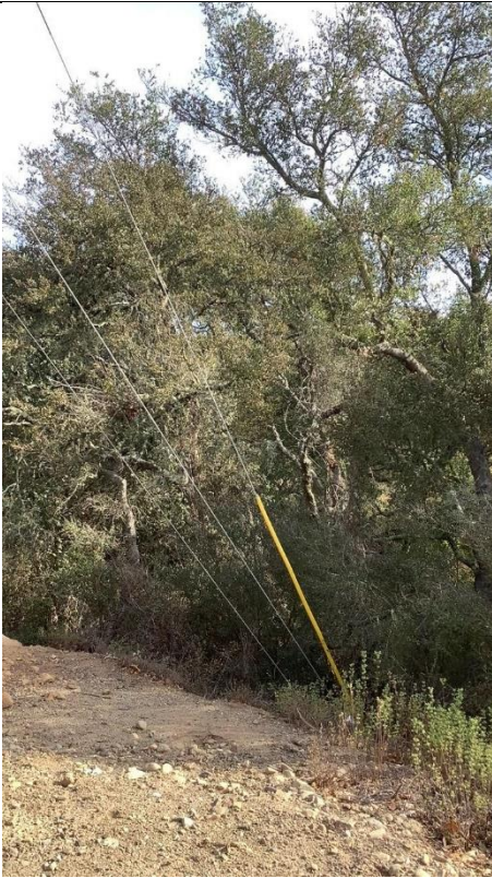
Item4GW1Img1: Loose guy wire
