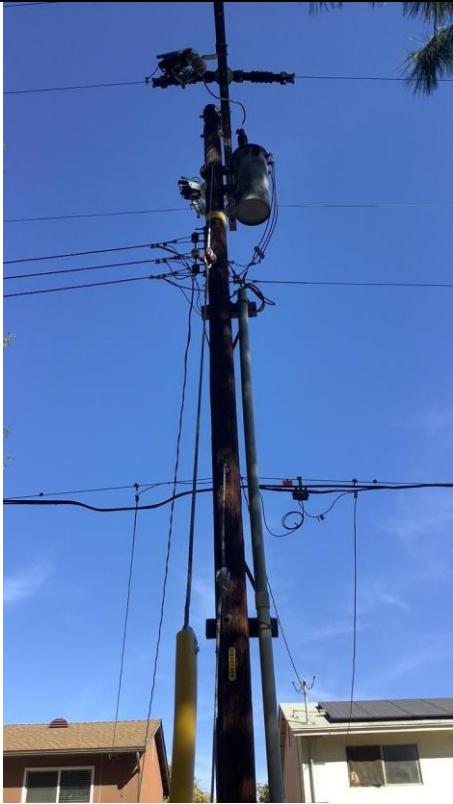
Item7GW1img1: Loose guy wire
