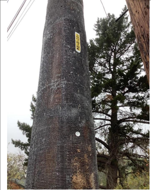
Item5GIimg2: Pole ID
