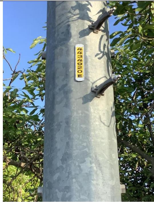
Item12GIimg2: Pole ID
