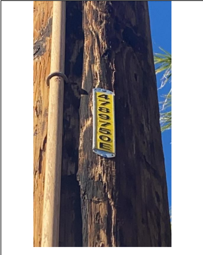
Item14GIimg2: Pole ID
