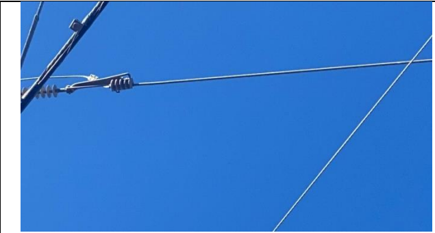
Item1IA2Img3: Bare conductors
