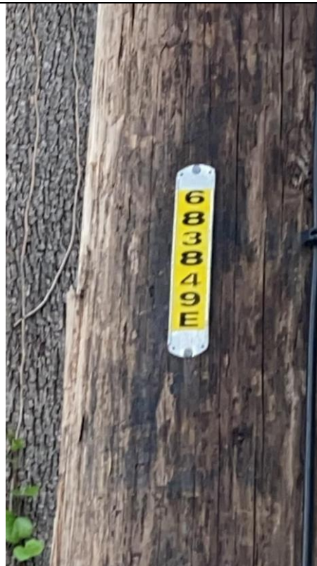
Item1GImg2: Pole ID
