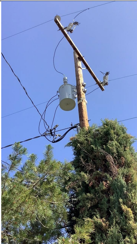
Item1GImg1: Pole assets
