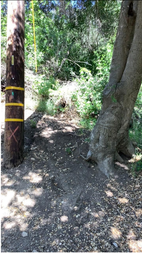
Item7Gimg3: Pole base
