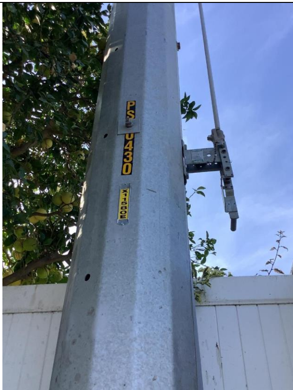
Item4Gimg1: Pole ID
