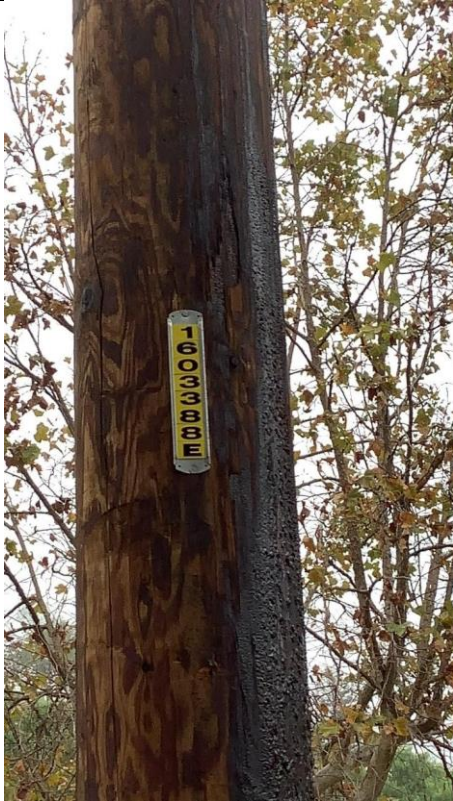
Item2Gimg1: Pole 1603388E
