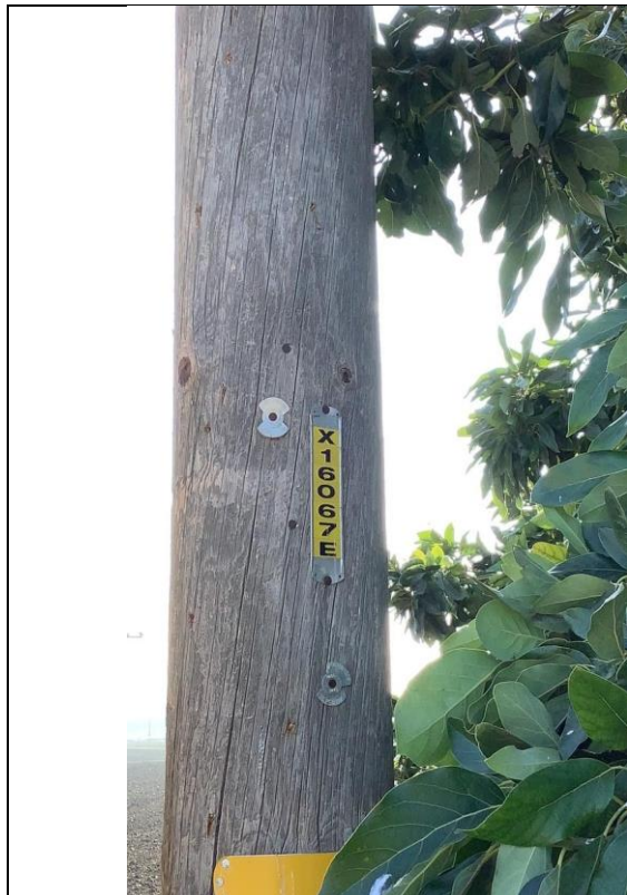
Item1Gimg1: Pole X16067E
