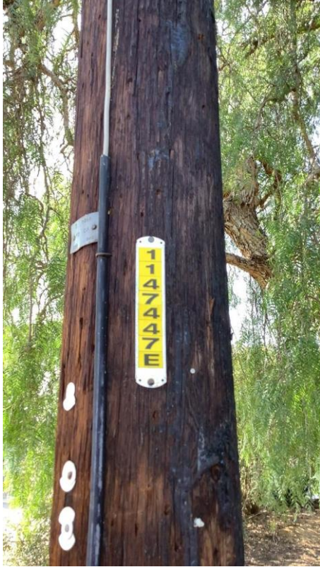
Item1Gimg1: Pole 1147447E
