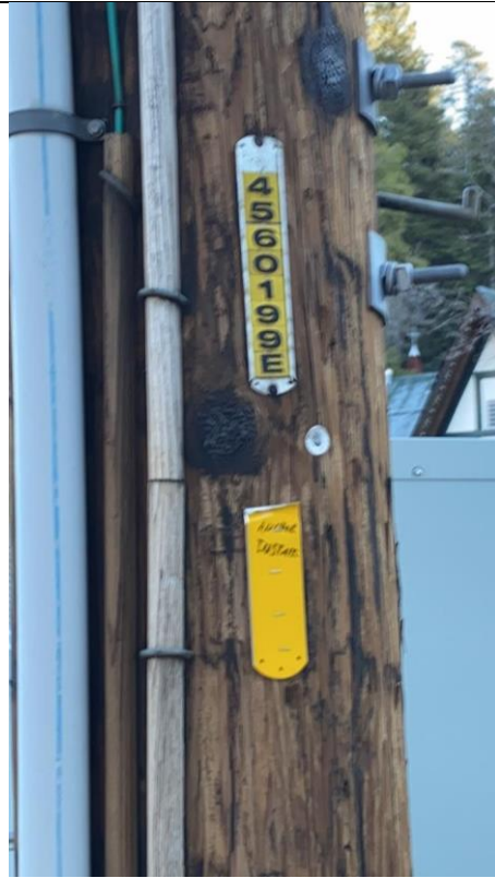
Item2GImg2: Pole ID
