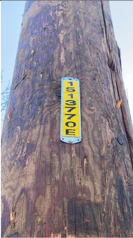
Item16GImg2: Pole ID
