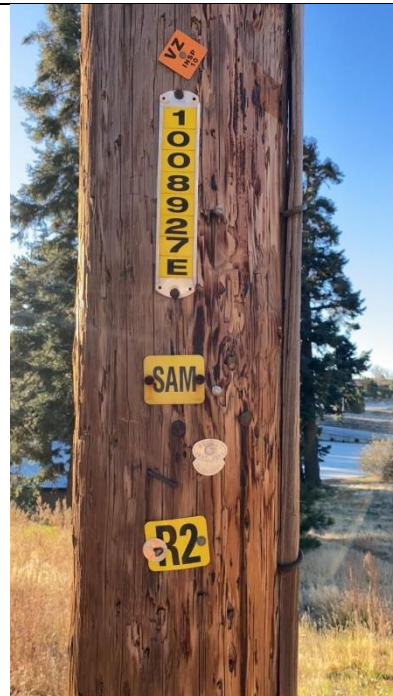
Item1Gimg2: Pole ID
