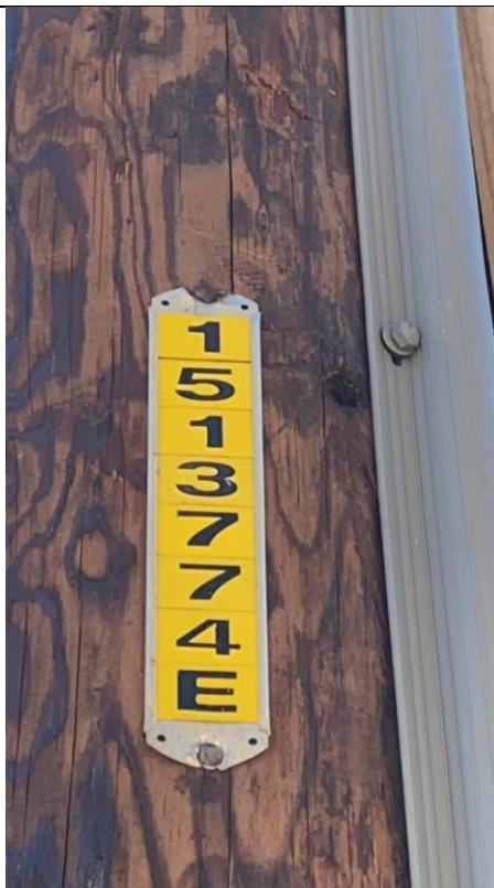
Item14Gimg2: Pole ID
