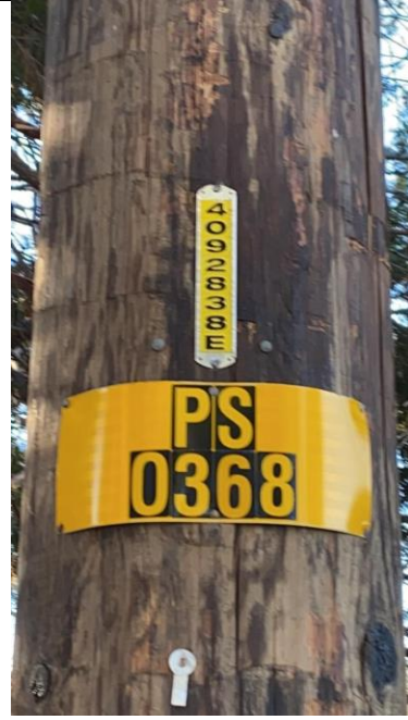
Item3GImg2: Pole ID
