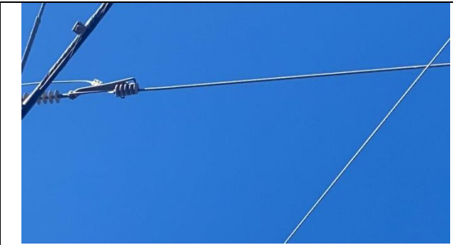
Item1IA2Img3: Bare conductors
