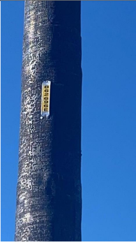
Item11GImg2: Pole ID
