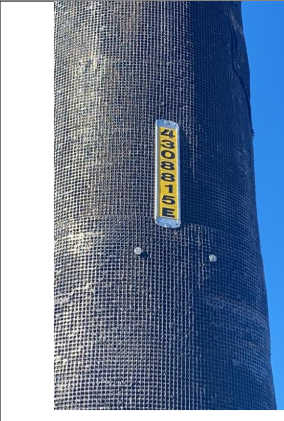
Item10GImg2: Pole ID
