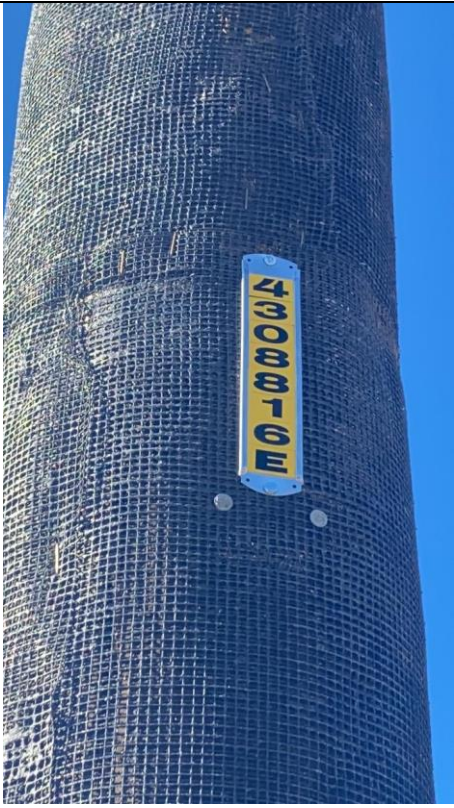
Item12GImg2: Pole ID
