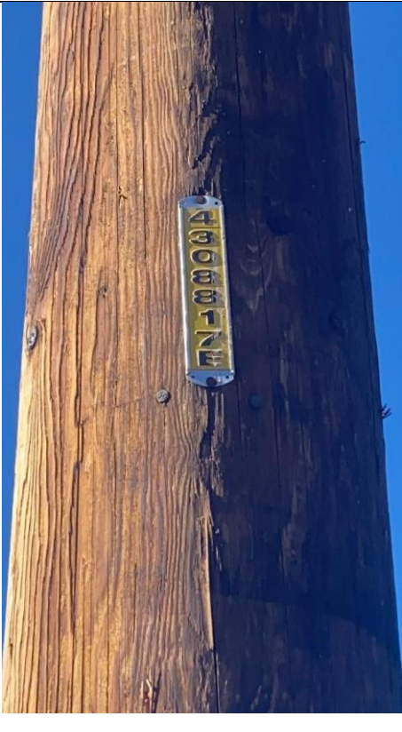
Item13GImg2: Pole ID
