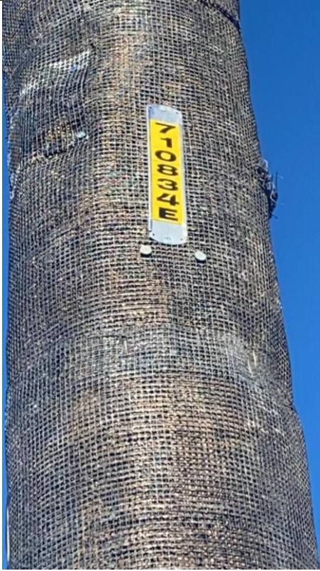
Item3GImg2: Pole ID
