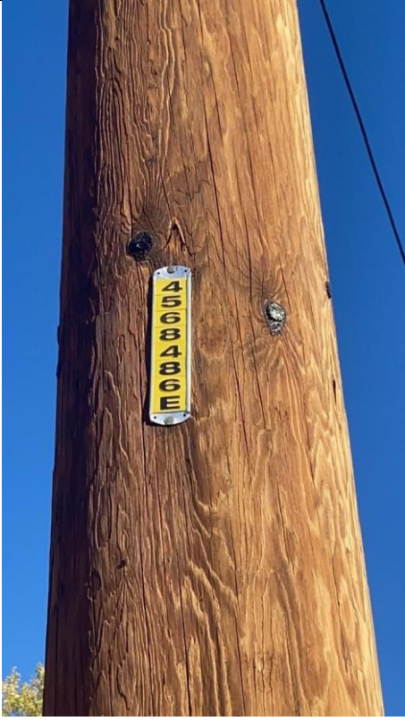
Item15GImg2: Pole ID
