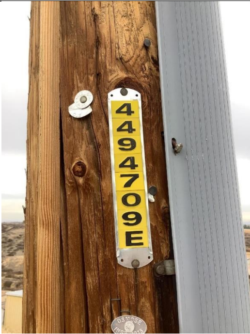
Item15Gimg1: Pole ID
