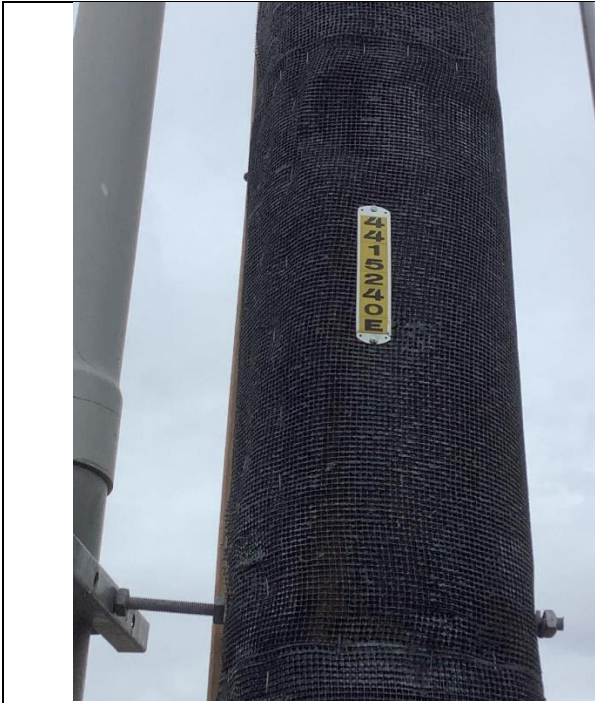
Item16GImg1: Pole ID
