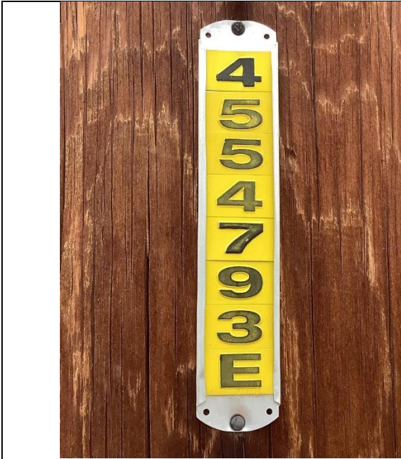
Item9GImg1: Pole ID
