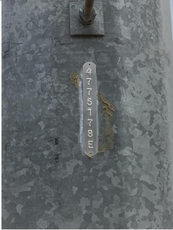
Item19GImg1: Pole ID
