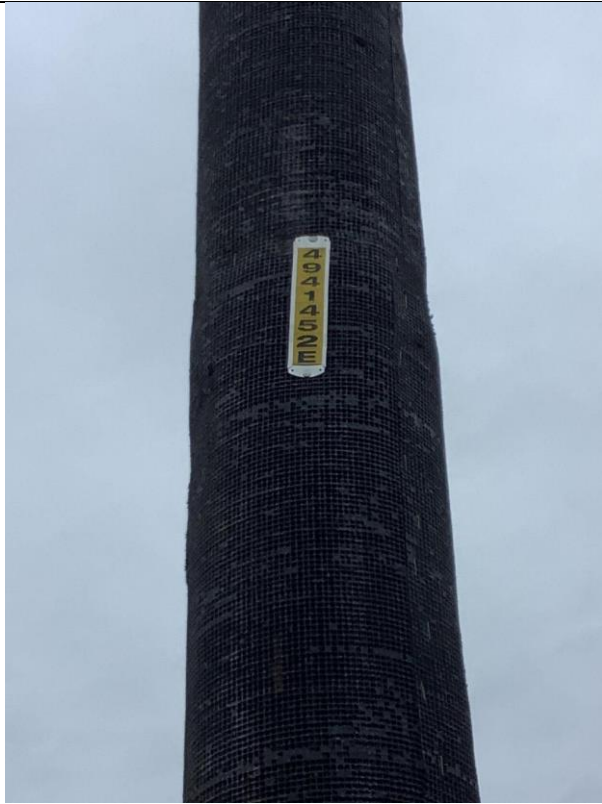
Item2GImg1: Pole ID
