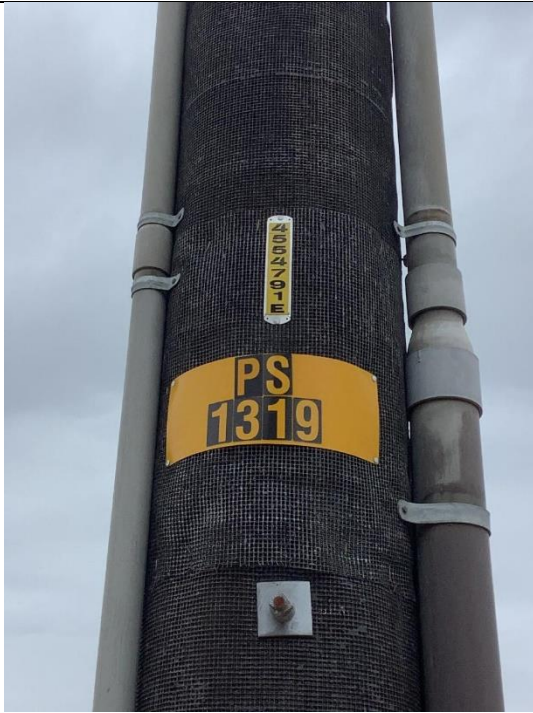
Item11GImg1: Pole ID
