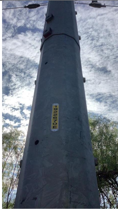
Item2GImg2: Pole ID
