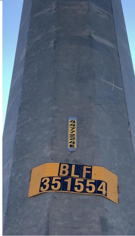
Item5GImg2: Pole ID
