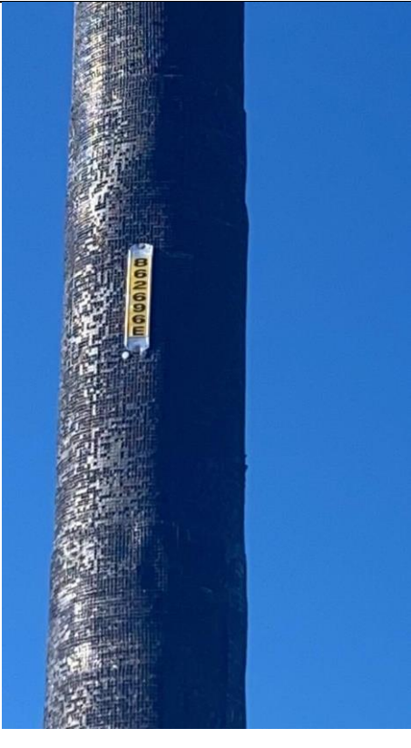
Item11GImg2: Pole ID
