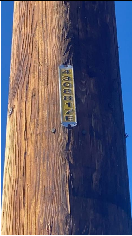
Item13GImg2: Pole ID
