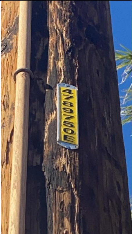
Item14GImg2: Pole ID
