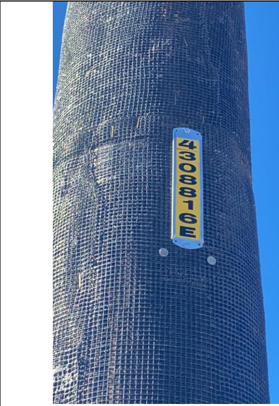
Item12GImg2: Pole ID
