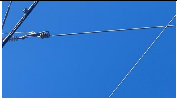
Item1IA2Img3: Bare conductors
