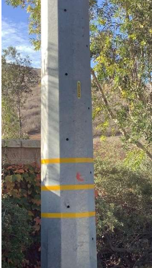
Item1GImg1: Pole 4194272E
