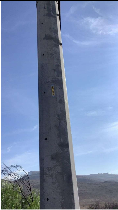
Item8GImg1: Pole 4477220E
