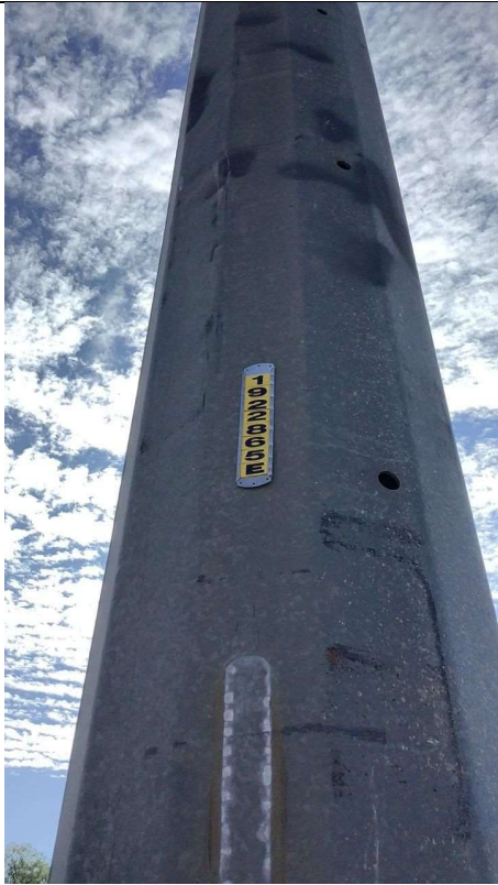
Item4GImg1: Pole 1922865E
