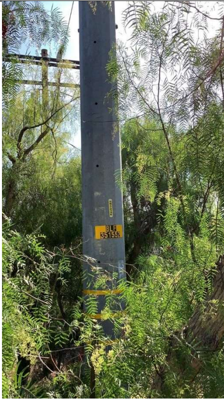
Item9GImg1: Pole 4477213E
