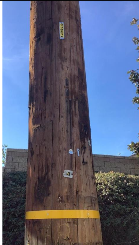
Item4GImg2: Pole ID
