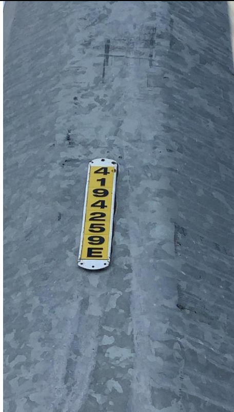
Item8GImg2: Pole ID
