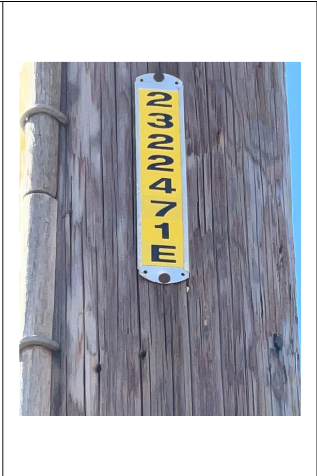
Item1Gimg2: Pole ID.
