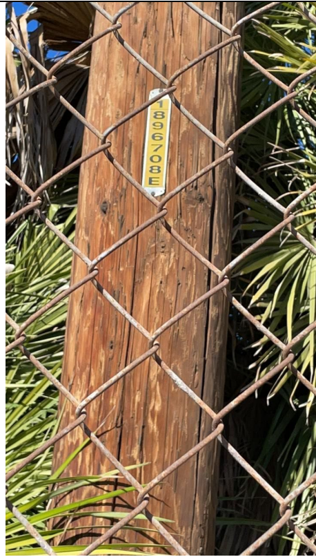
Item2GImg2: Pole ID
