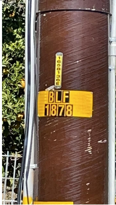
Item3Gimg2: Pole ID
